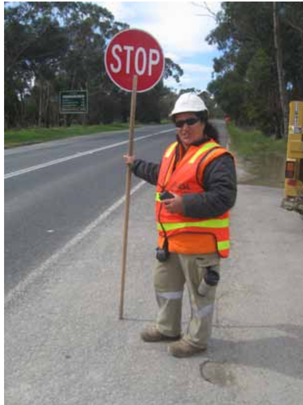
Ажилчид болон замын хөдөлгөөний хяналт зохицуулагч нарыг цаг уурын нөхцөлд тохирсон хувийн хамгаалалтын хэрэгсэл хувцасаар хангах ёстой. Үүнд өдрийн цагаар тод харагддаг мөн шөнийн цагт гэрэл ойлгогчтой цацрах чадвартай, харагдац сайтай тод өнгийн хүрэм эсвэл хантааз ордог.
