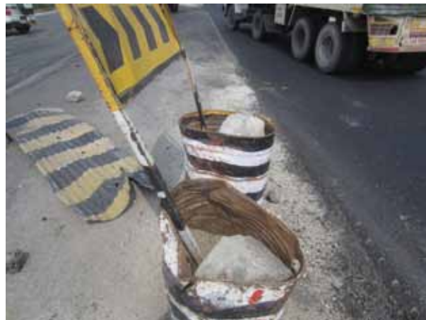
Авто замын барилгын ажлын талбайд сайн тэмдэг тэмдэглэгээ хийх нь чухал ба энэ нь хэт хатуу бус, мөн гэрэл ойлгогчтой байх шаардлагатай. Будсан торхонд бетон блок хийх нь аюултай юм.
