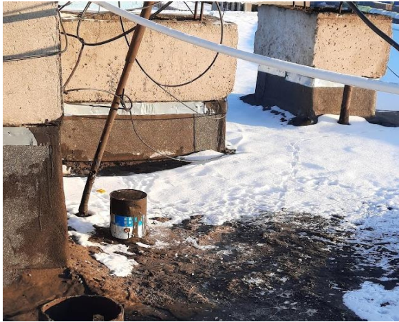
Зур.2.6. Дээрийн хучилт, ус нэвтэрсэн хэсэгт засвар хийсэн байдал.
