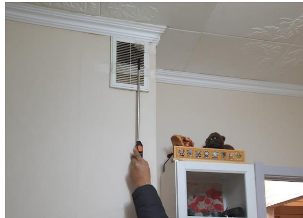
Зур.2.27. Айлын гал тогооны өрөөний сорох сараалж дээрх агаарын хурд, температурыг хэмжив.
