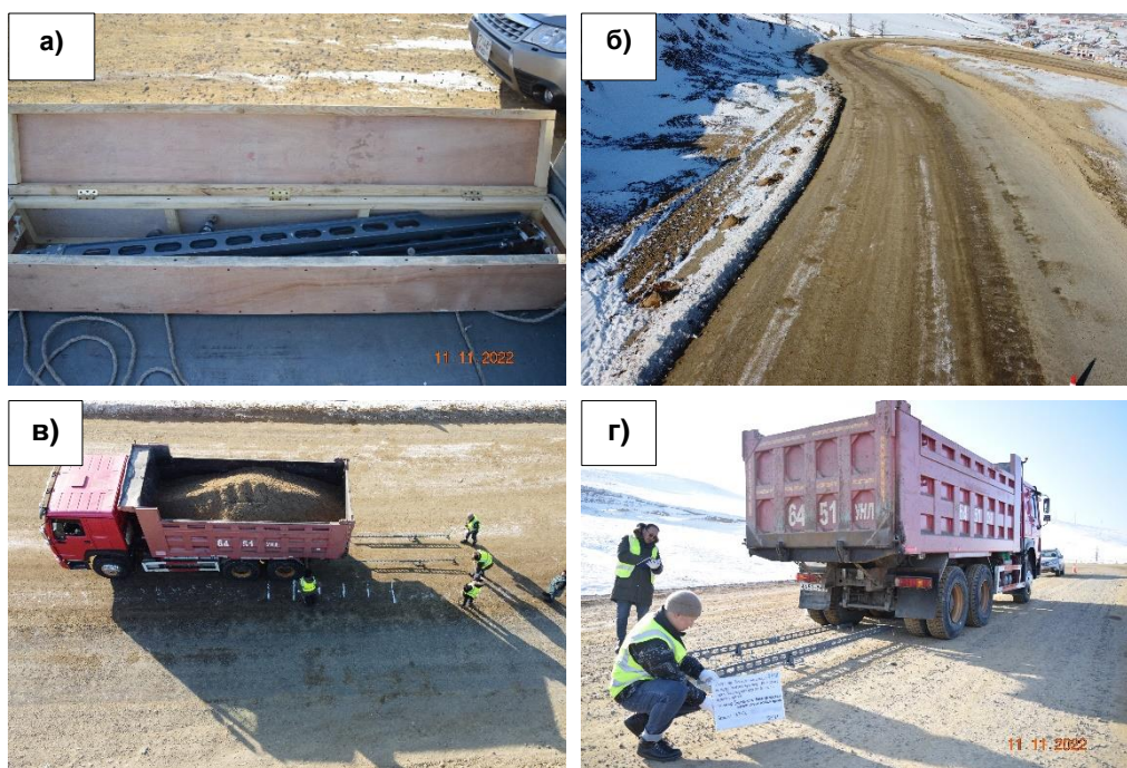
Зураг 2.7. а) WASHTO төрлийн Бенкельман багажийн харагдах байдал; б) хэмжилт хийсэн өдрийн талбайн нөхцөл байдал; в) туршилтын үйл явц; г) туршилтын цэг №8-ийн хэмжилт;
