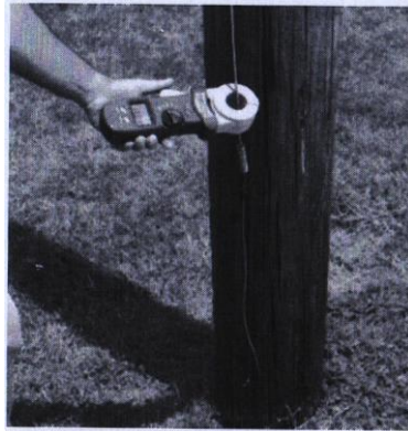
Зураг 5.6 а . Гүйдлийн тансформаторын зарчим бүхий хэмжилтийн хавчаараар газардуулгын эсэргүүцлийг хэмжих байдал (Megger DET20C)
