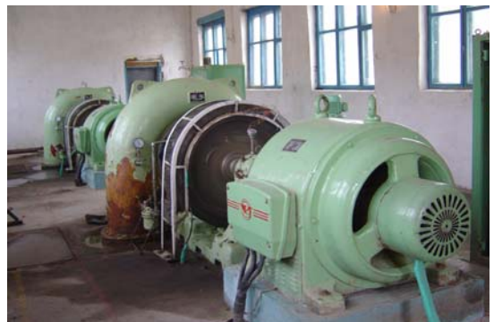
УЦС-ын турбин генератор
