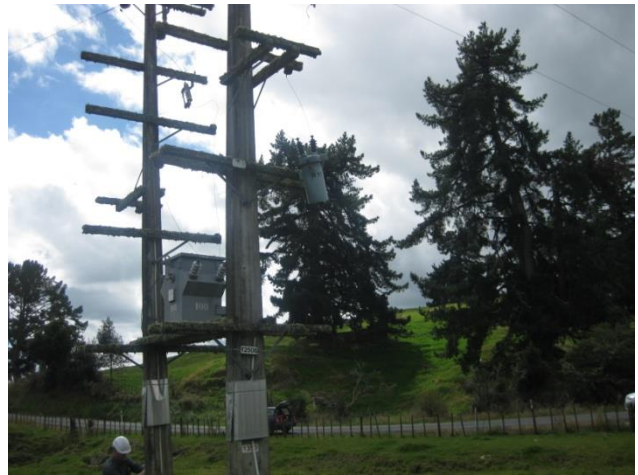
Тусгаарлагч трансформаторыг байрлуулсан байдал ба шугам хамгаалах хэрэгслэл Зураг14.
