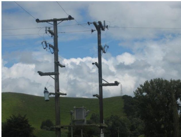
Нэг фазын шугамын салаалсан байдал зэрэгцээ хоёр тулгуур дээр холбогдсон байгаа нь. Зураг-13
