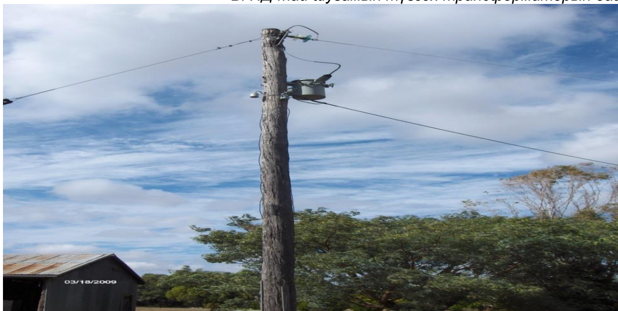
БГНД-тай шугамын түгээх трансформаторын байдал
