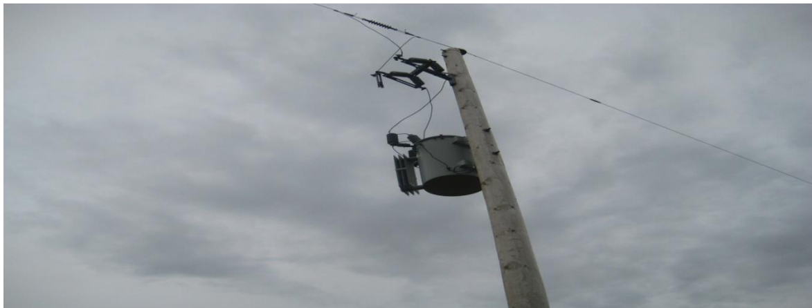
Канад улсад хэрэглэж байгаа "Буцах газардуулгатай ганц дамжуулагч /БГНД /-тай 15 кВ-ын цахилгаан түгээх шугамын байдал. Зураг-17
