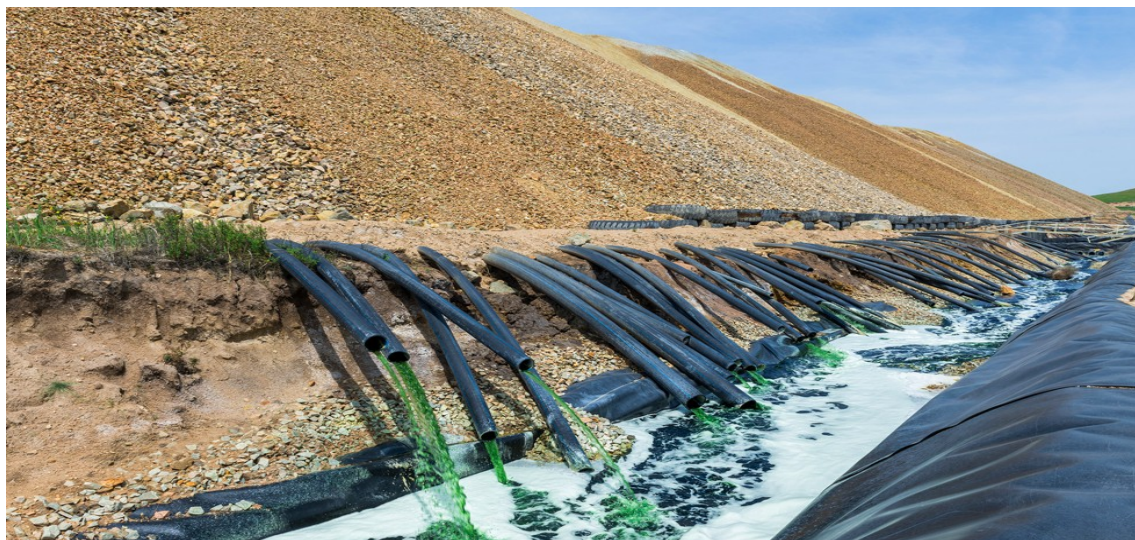
Зураг 2. Шимт уусмалын цөөрөм
