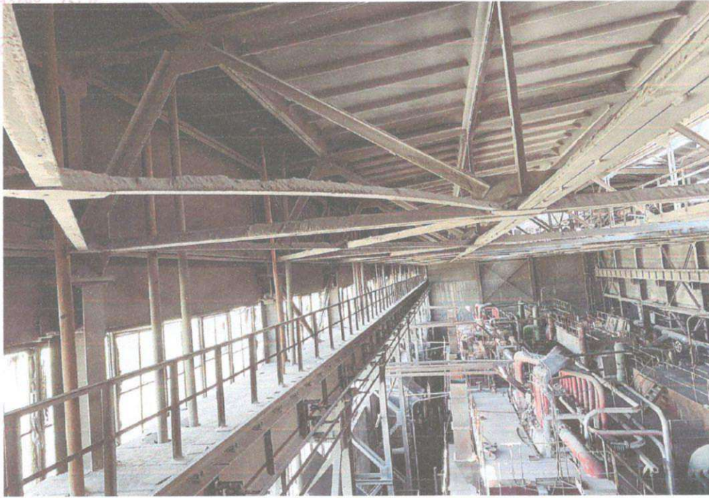
T12 ба T13 тулгуурын хоорондох татанга муруйж дээшээ гулзайсан байдал
