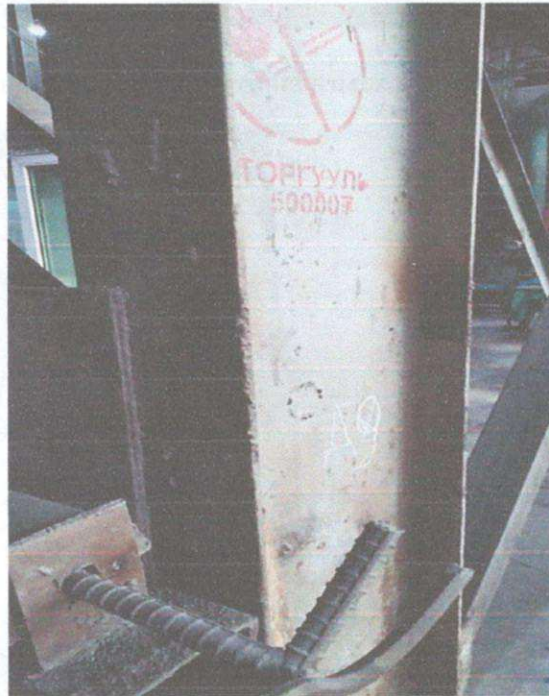
Д9 тулгуурт гагнуур хийгдсэн, хамгаалалтын будаг ховхорч зэврэлт ссэн байдал
