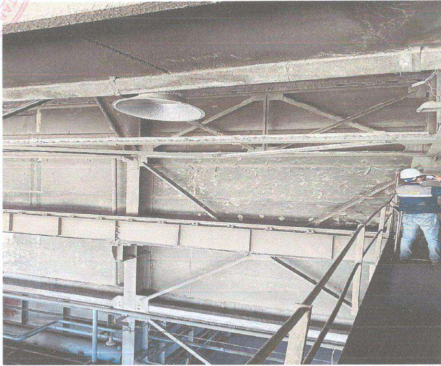
Хажуу хананы будаг ховхорсон байдал
