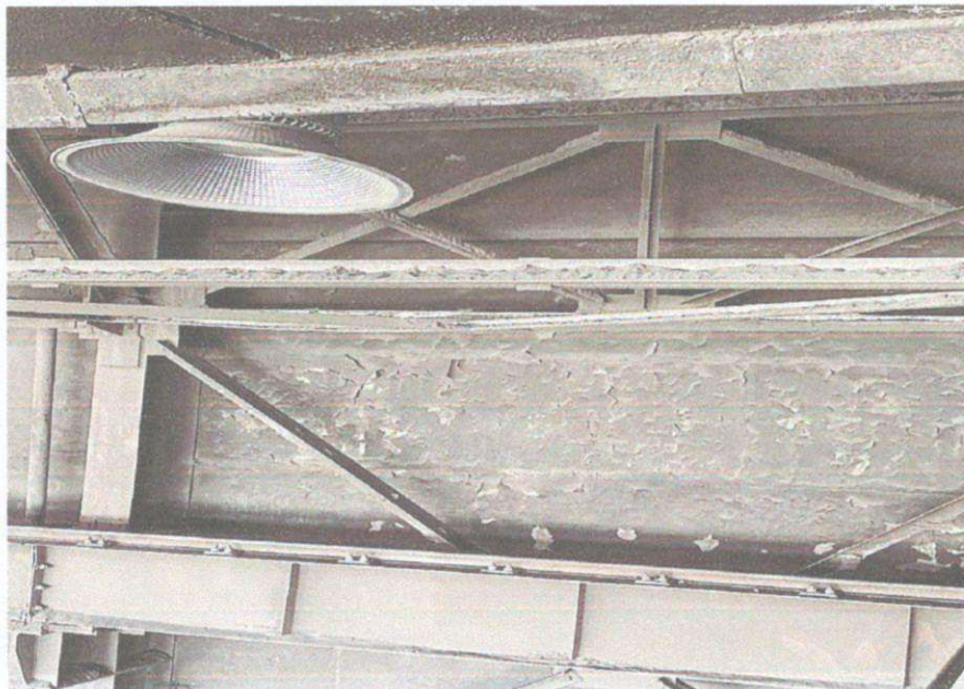
Хажуу хананы будаг ховхорсон байдал
