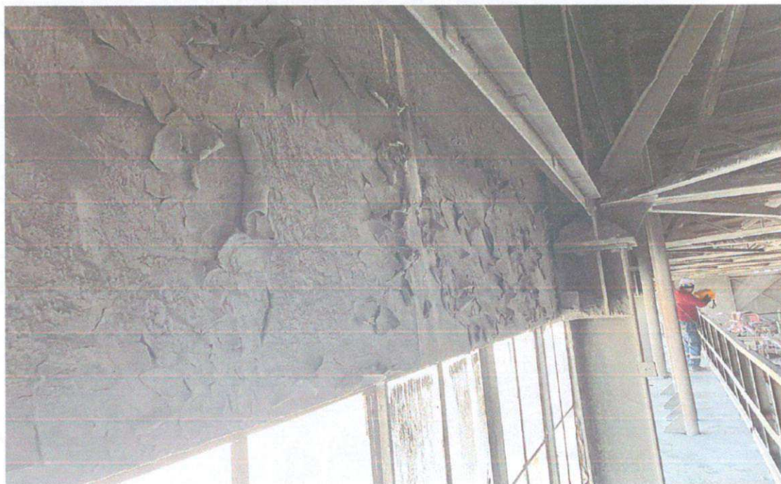
Хажуу хана хамгаалалт ховхорсон байдал
