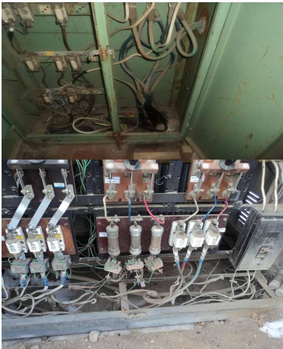
Зураг 2.11 Орон сууцны 0,4кВ-ын оруулгын щитний байдал
