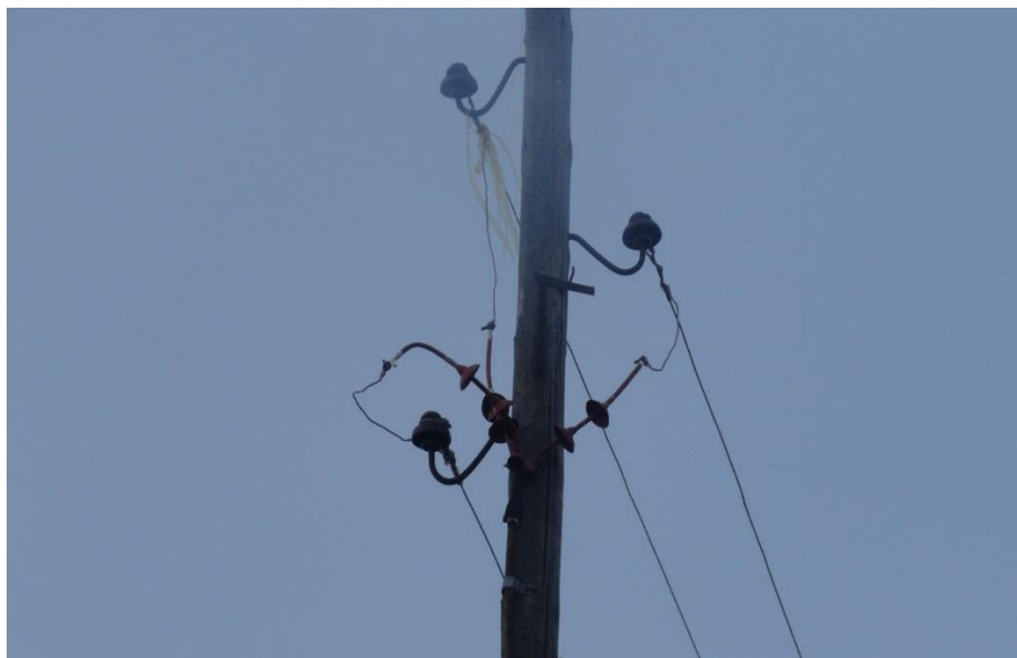
Зураг 2.7 Одоо ашиглагдаж байгаа 10кВ-ын ЦДАШ-ын байдал
