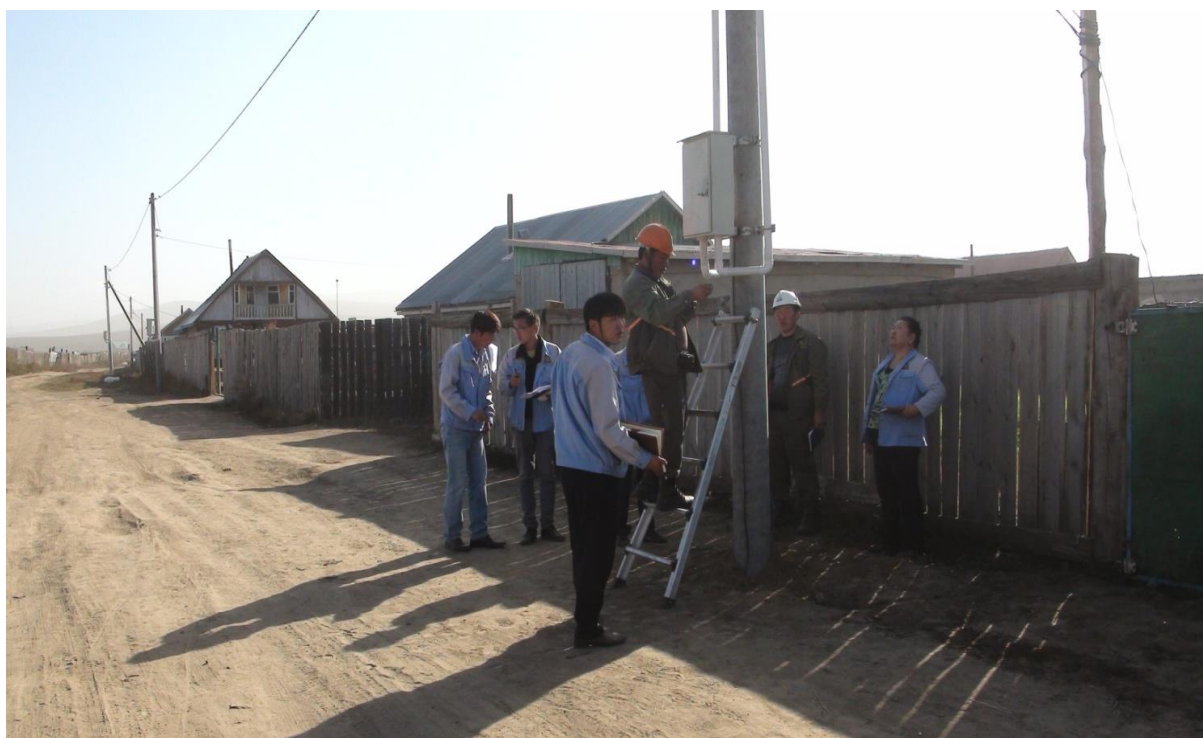
Зураг 2.15 Багцалсан тоолууруудын хайрцагийг гадаа шонд байрлуулсан байдал
