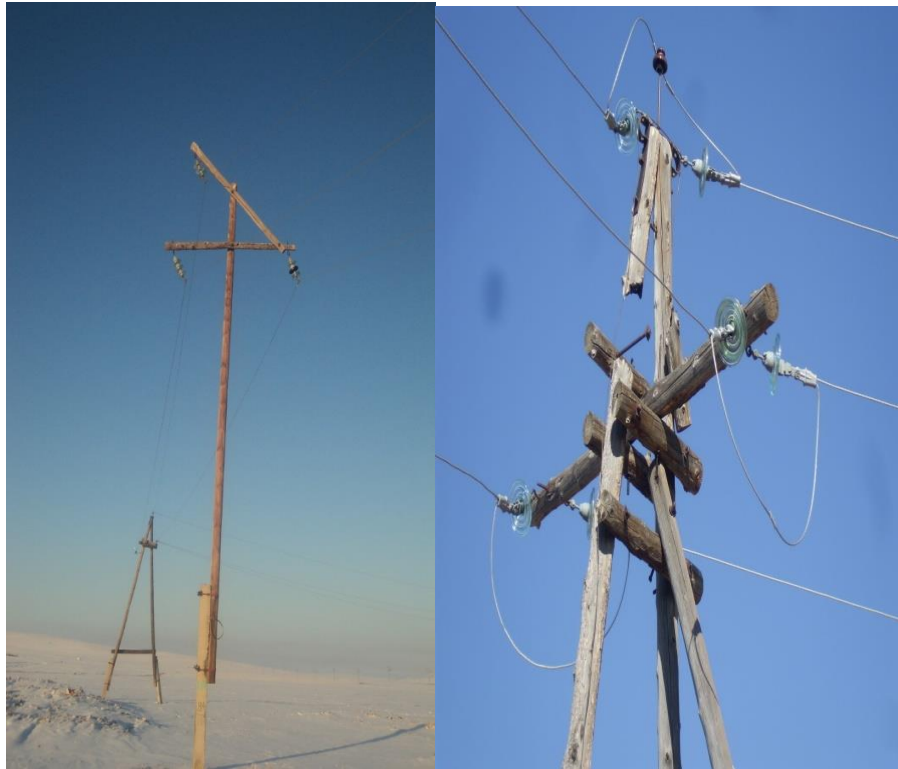
Зураг 2.6 Цагаандэлгэр-Говь-Угтаал 35кВ-ын ЦДАШ-ын ашиглалтын байдал
