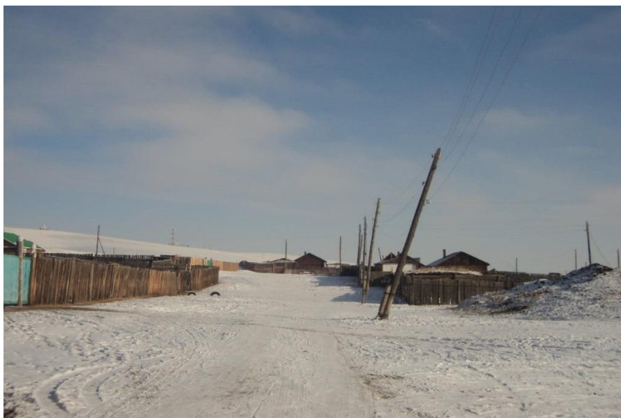
Зураг 2.9 Одоо ашиглагдаж байгаа 0,4кВ-ын ЦДАШ-ын байдал
