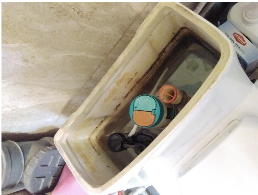
Зураг 46: СБД-д байрлах орон сууцны суултуурын дотор тал зэвэрсэн байдал
