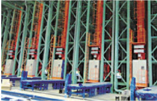
자동창고 상품팔레트 보관 및 무인 입·출고 설비
