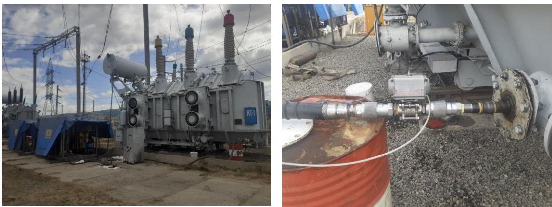
Зураг 20. Цэвэрлэх төхөөрөмжийн трансформаторт холбосон байдал
