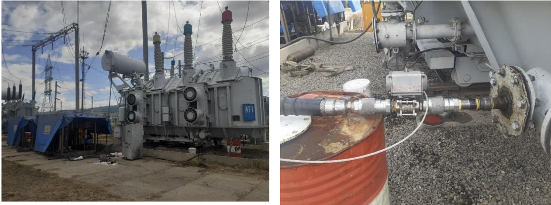
Зураг 21. Цэвэрлэх төхөөрөмжийн трансформаторт холбосон байдал
