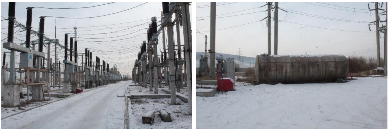
Зураг 4. Дэд станц болон Ёмкость
