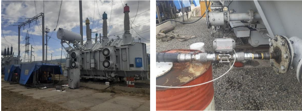
Зураг 18. Цэвэрлэх төхөөрөмжийн трансформаторт холбосон байдал
