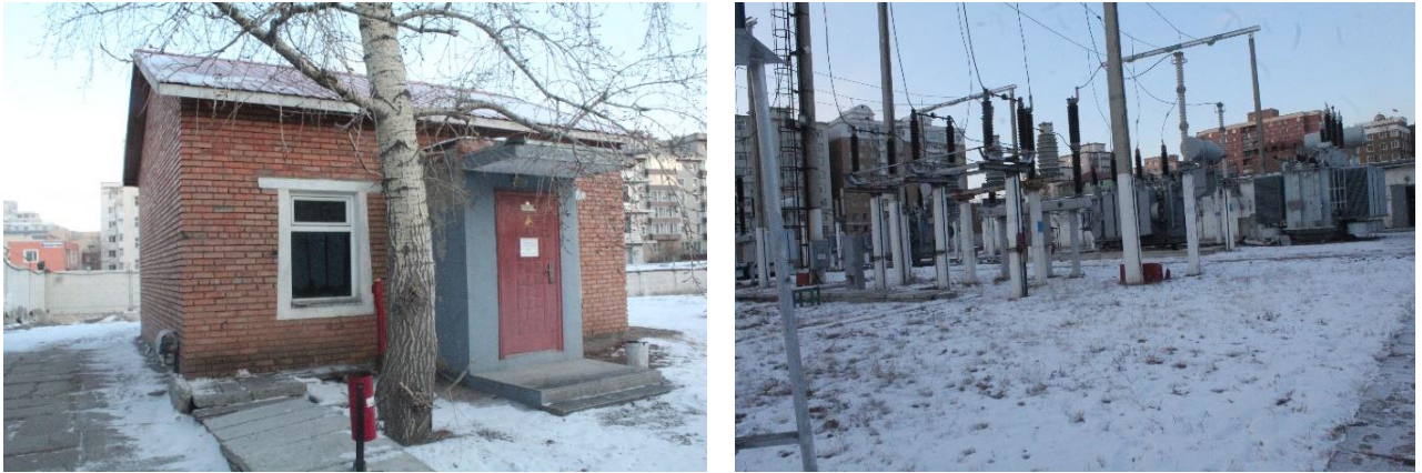
Зураг 1. Талбай доторх барилга байгууламж болон дэд станц
