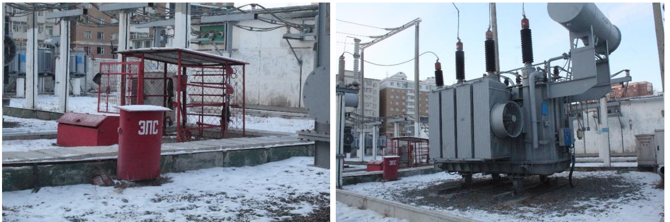
Зураг 2. Галын сараа болон трансформатор
