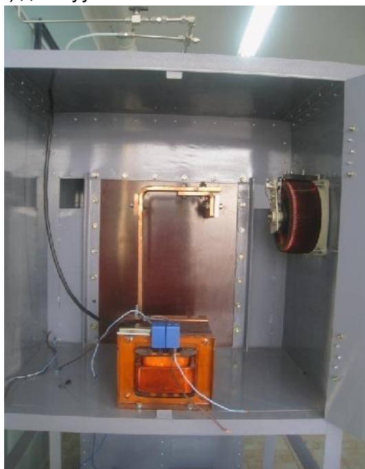
35-р зураг. 220В-ыг 2 В болгон хувиргадаг трансформатор
