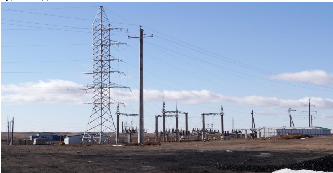
Зураг 15. Дэд станц
