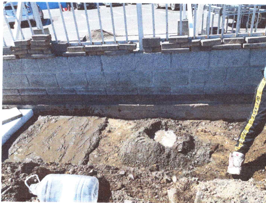
Зураг 14. Явган замыг хуулж 40 см ухаад бетон хийж, дээр нь хөөс байрлуулж байна.
