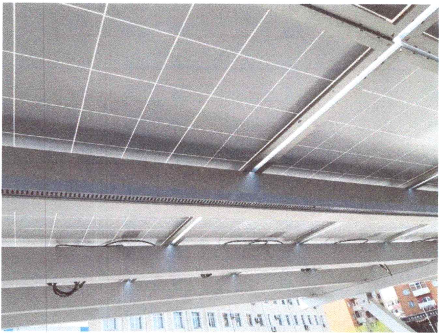
Зураг 17. Кабель утасны холболт
