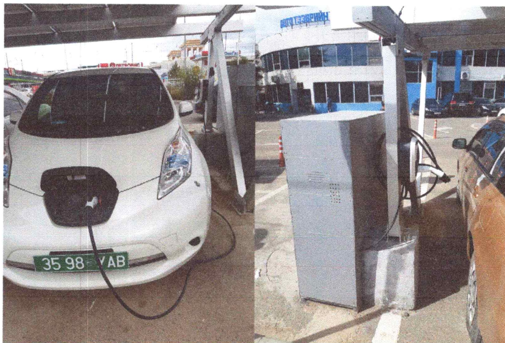
Зураг 16. Цахилгаан машин цэнэглэгч станц /7кВт/
