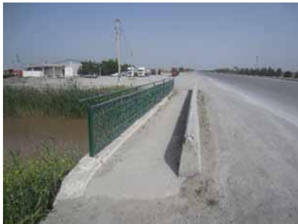
Гүүрийн хайс нь нөлөөлөлд орсон тээврийн хэрэгсэлийг зогсоож чадахуйц хангалттай бат бөх байх ёстой. Иймэрхүү хөнгөн төрлийн хайс нь тэр хэмжээний хангалттай бат бөх байж чадахгүй. Нам байрласан бетон хаалт нь ч өөр нэгэн аюул болж байна.
