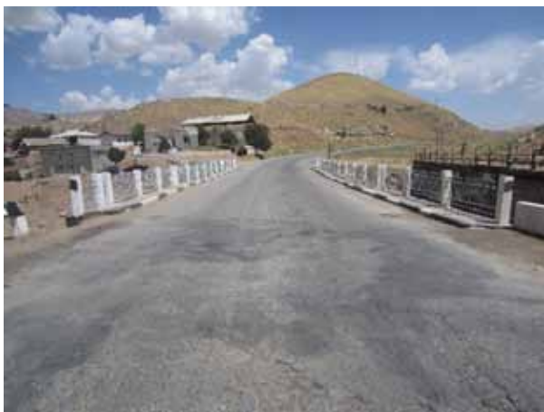
Энэхүү нарийн гүүр нь тэмдэглэлгүй байна. Шөнийн цагаар зарим жолооч нар гүүрэн дээр зам нарийсч буйг анзаарахгүй байж болно. Гүүрийн бүх өнцөгт түүний өргөнийг тэмдэглэж өгснөөр жолооч нарт зам нарийсч байгааг мэдэгдэнэ.
