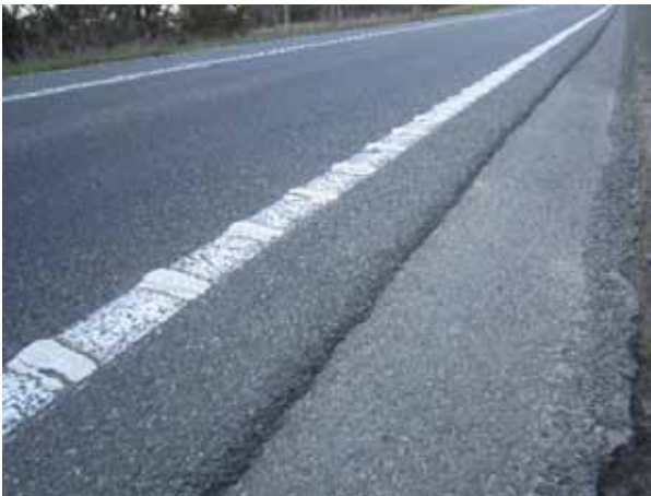
Захын товгор шугам нь замаас хазайн гарах үзэгдэлийг багасгадаг болох нь нотлогдсон. Эдгээрийг хучилттай хөвөөтэй хослуулан ашиглах нь илүү тохиромжтой байдаг.
