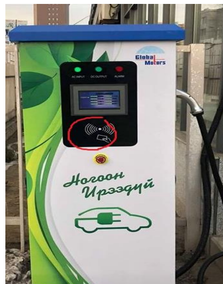
Зураг. 1 Глобал Моторс ХХК -ны тогтмол гүйдлийн цэнэглэх станц
