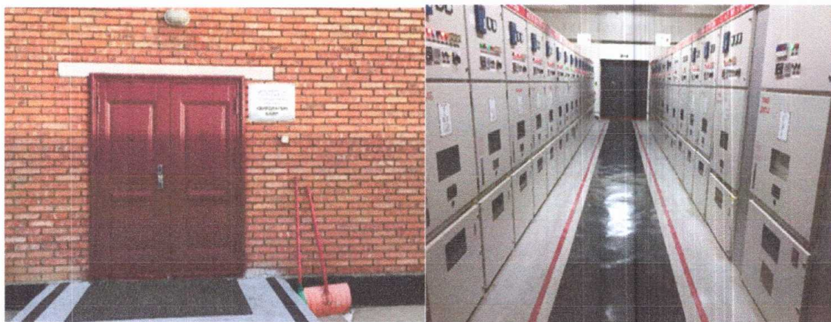
Зураг 9. УБ салбар 110/10 кВ-ын 110/35/10 кВ-ын 7-р хорооллын дэд станц
