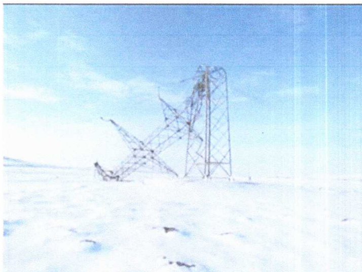
Зураг 3.10. 220 кВ-ын засварын төмөр тулгуур дамжуулагч утсанд тогтсон цас болон мөсний ачааллаас болж хугарч унасан байдал
