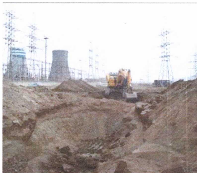
Зураг 4.3. Өндөр хүчдэлийн шугам олноор байрласан газар зөвшөөрөлгүй үйл ажиллагаа явуулж буй байдал
