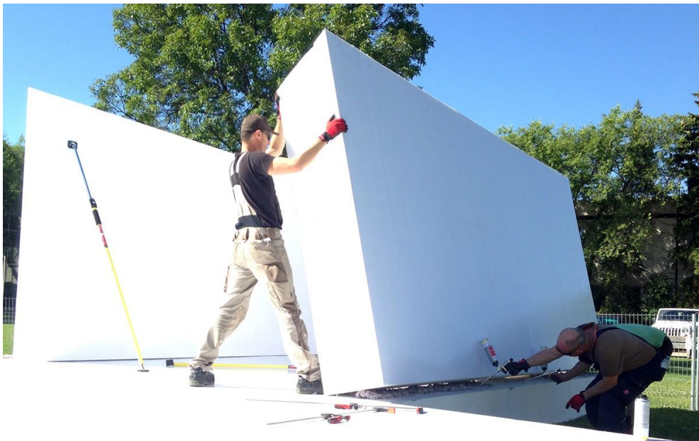
35-р зураг. Канадын цэвдэгтэй бүсэд хувийн байшинд гадна тулгууртай барилгын суурин дээр хөөсөнцөр ашиглан дулаан тусгаарлаж байгаа жишээ.
