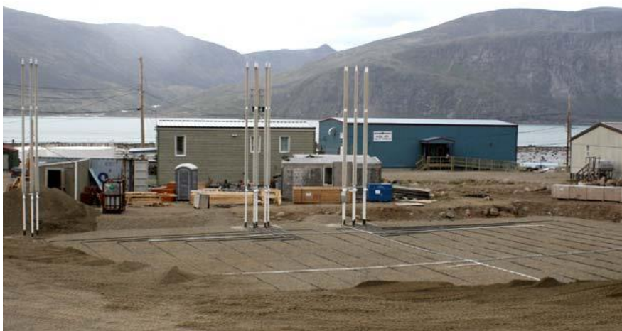
31-р зураг. АНУ-ын Аляск мужид барилгын сууринд хэвтгэй ууршуулагчтай термосифон хоолой ашиглаж буй жишээ (Holubec, 2008).
