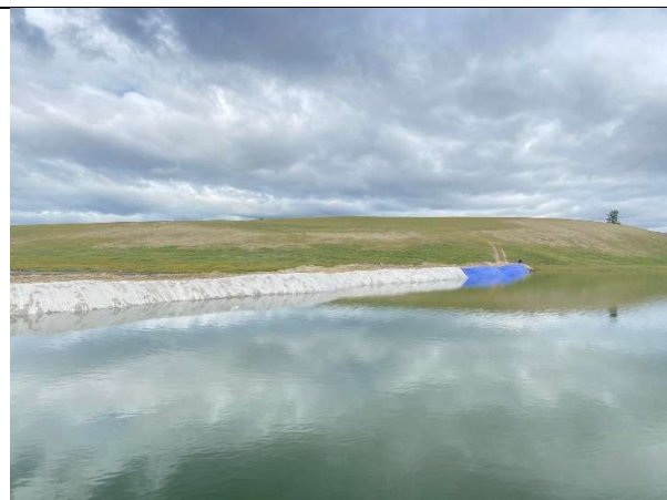
Зураг 6: Барилгын ажлын үеийн түр далангийн дээд налууд ус тусгаарлах гялгар материал /t=5 мм/ хийсэн байдал
