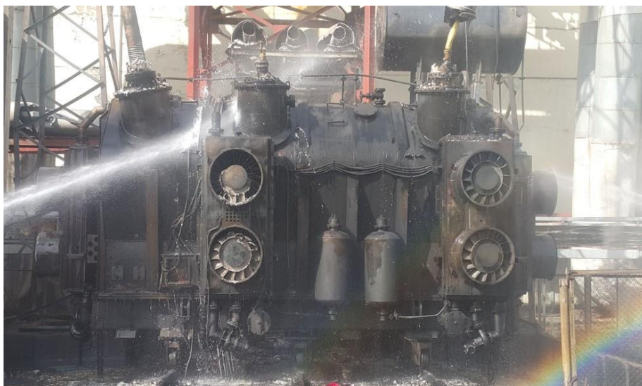
Гэмтлээс үүдэн шатсан 3Т трансформатор
